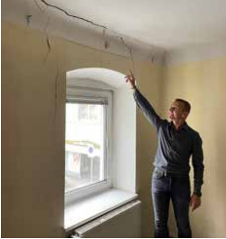
Der Altbau war aufgrund fehlender Fundamente und Risse nicht mehr zu retten.
