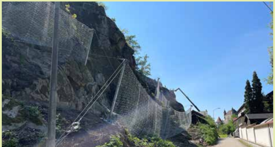
Bis Sommer sind alle Schutzmaßnahmen abgeschlossen – in wenigen Monaten wird der natürliche Bewuchs die Netze teilweise wieder verdecken.
