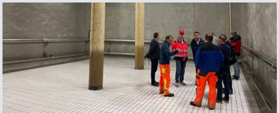
Die Ursachenforschung der Korrosionsschäden ist noch im Gange. Die Firma STRABAG muss alle Mängel auf ihre Kosten beheben.
