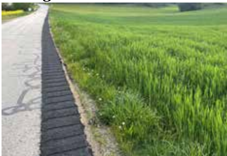
Die neuen Bankette können nach heftigen Regenfällen nicht ausgeschwemmt werden.
