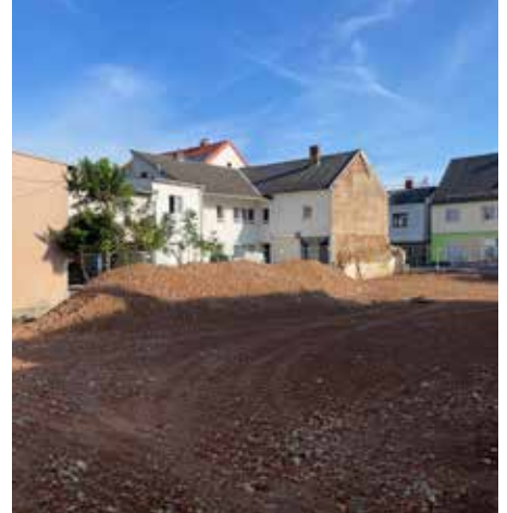
Binnen einer Woche wurde das alte Gebäude vollständig abgerissen. Das freie Baufeld prägt für eine Weile das Ortsbild.
