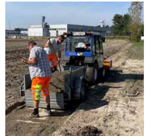
Ein großes Dankeschön gebührt dem Bauhof-Team unter der Leitung von Gottfried Leimlehner, das nach dem Hochwasser kleinere Schäden beseitigt hat. Der Rad- und Gehweg entlang der Aist, zwischen der Hödlmayr-Wehr und dem Dachsberg, konnte rechtzeitig vor dem ORF-Wandertag wiederhergestellt werden.
