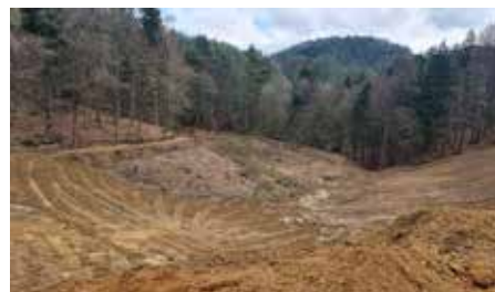
Maximal 15.000 Kubikmeter Sand und Erde dürfen zum Auffüllen eines Grabens in Windegg deponiert werden
