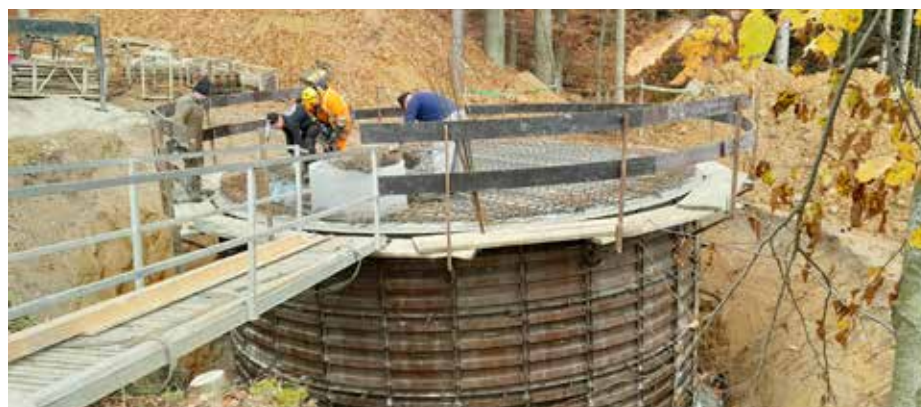
Durch die neue Anlage in Lina wird die Wasserversorgung bei Brandeinsätzen erleichtert.
